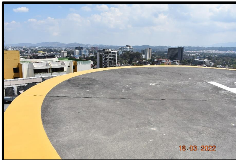
Fotografía No. 1 Vista del helipuerto ubicado en el Edificio Reforma.
