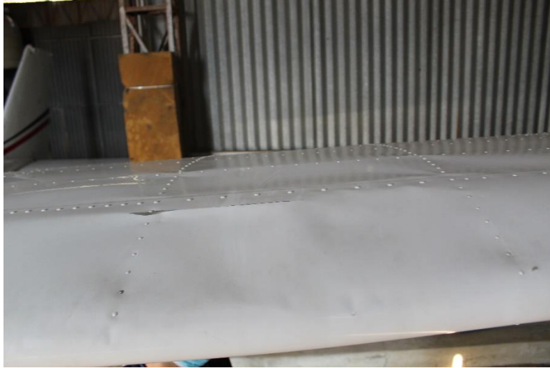
Fotografía No. 5 Daño por compresión.
